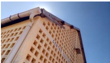
CCIC toiture avant réparation
